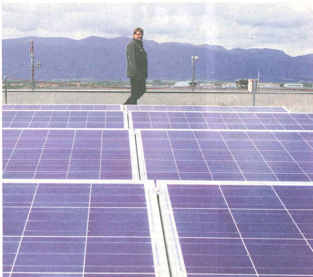
Panneaux solaires sur le toit de Palexpo. C'est aussi à Genève que la Convention mondiale des ingénieurs abordera la question du défi énergétique du futur. PATRICK GILLIERON LOPRENO
